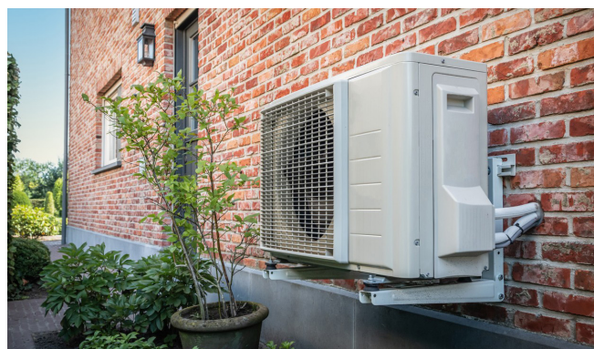
'Standaard' buiten-unit aan de gevel
