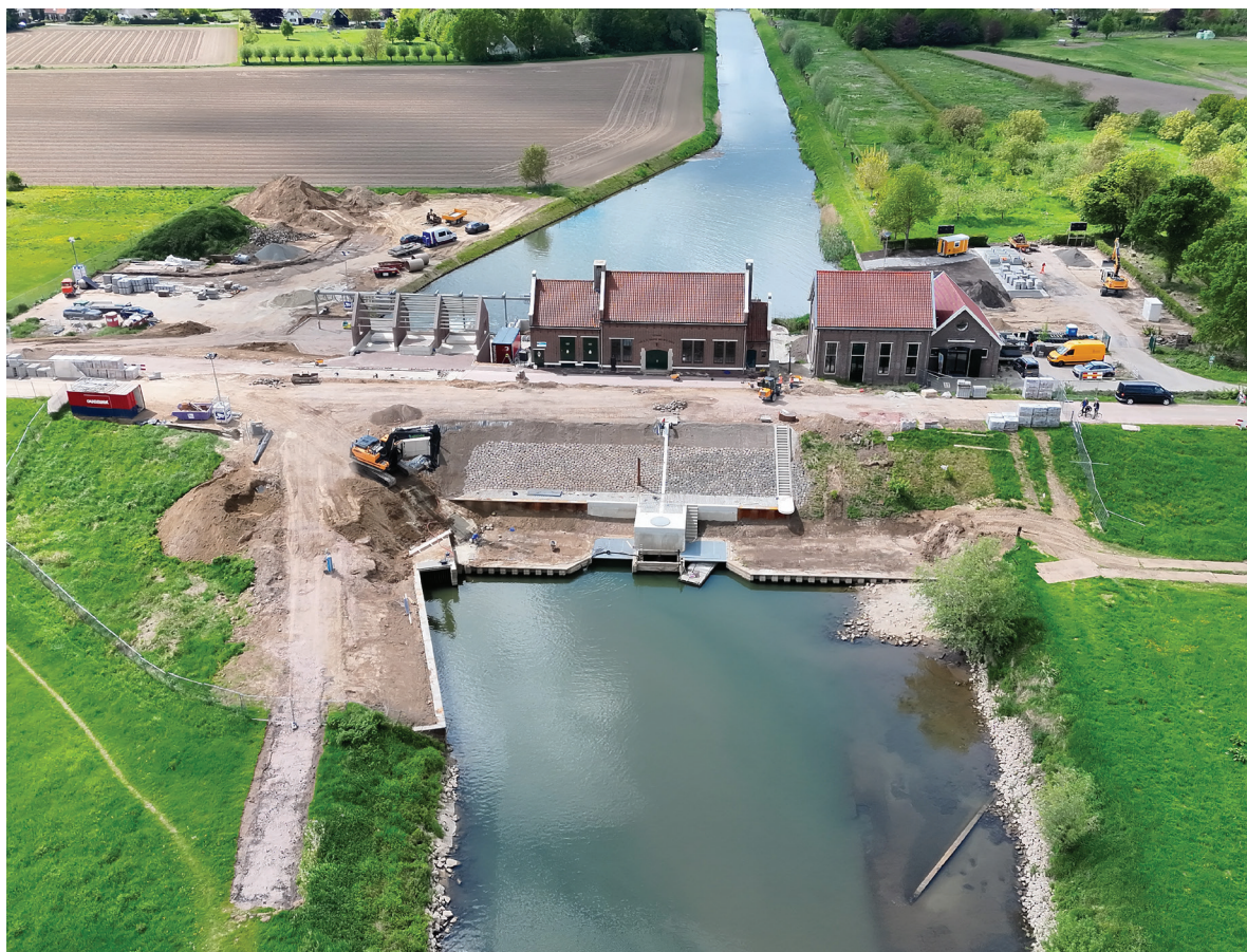
Figuur 32. Gemaal Terwolde (Bron: gemeente Voorst)
